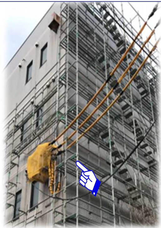
<防護管は取付けているものの、足場が高圧線に接触>
